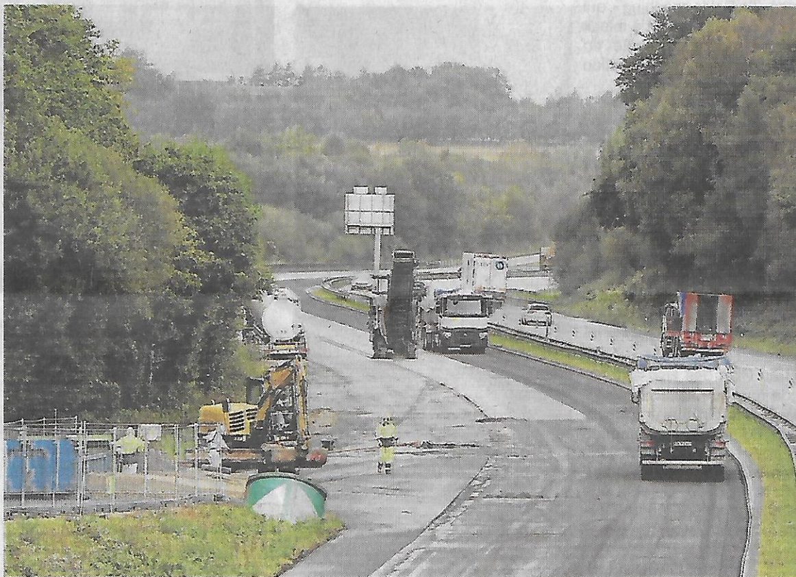
La menace de l'amiante est partout, y compris dans certains enrobés routiers comme ici, en train d'être retiré, sur une nationale près de Quimper.
